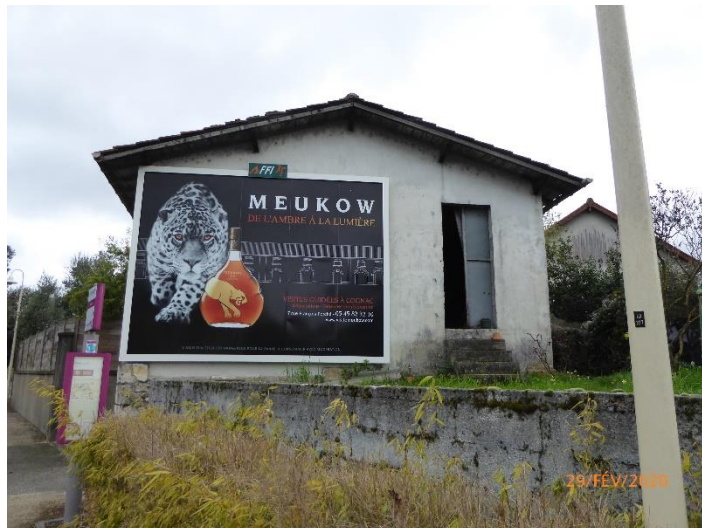
Installé sur un mur comprenant une ouverture de plus de 0,50m 2 (art.R.581-22 c.env.)
