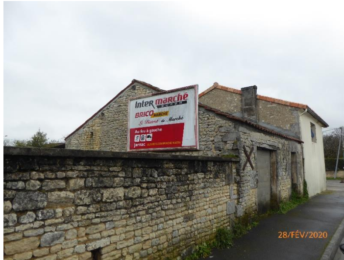
Dépasse les limites du mur (art.R.581-27 c.env.)
