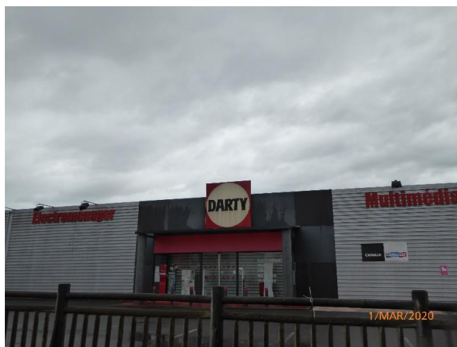
Enseigne en façade en dépassement des limites du mur (art.R.581-60 c.env.)
